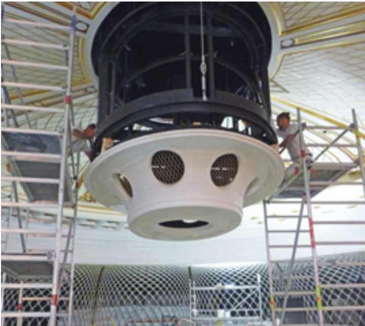
5 Die neu erschaffene Deckenleuchterkrone in der Berliner Staatsoper enthält die Bühnentechnik und kann in der Decke versenkt werden.
