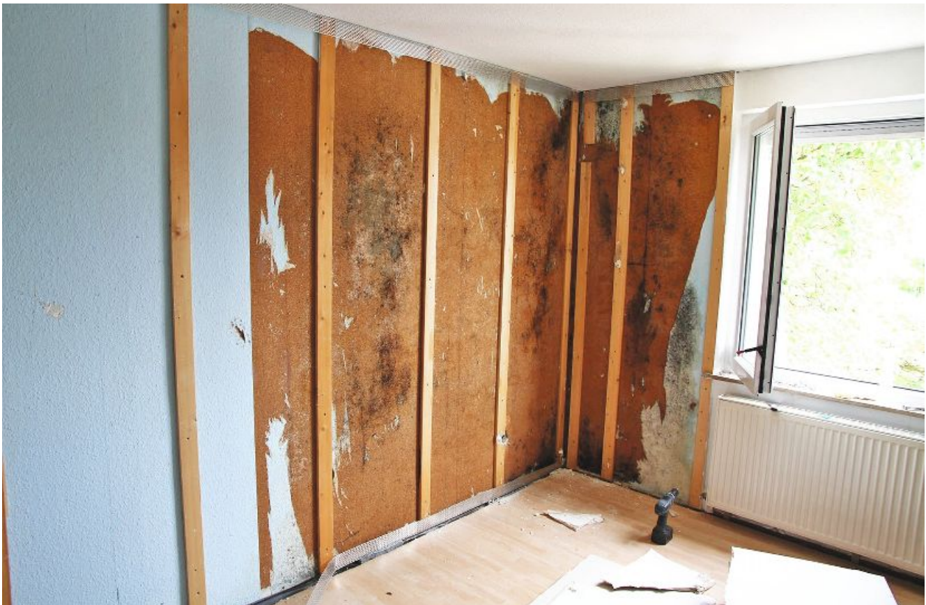
4 Verborgener Schimmelpilzbefall hinter einer Verkleidung.
